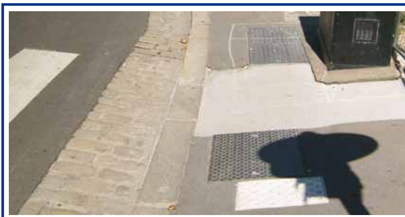
Bande podotactile blanche interrompue suite à des travaux
