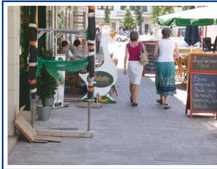
Échafaudage mal protégé, trottoir encombré
